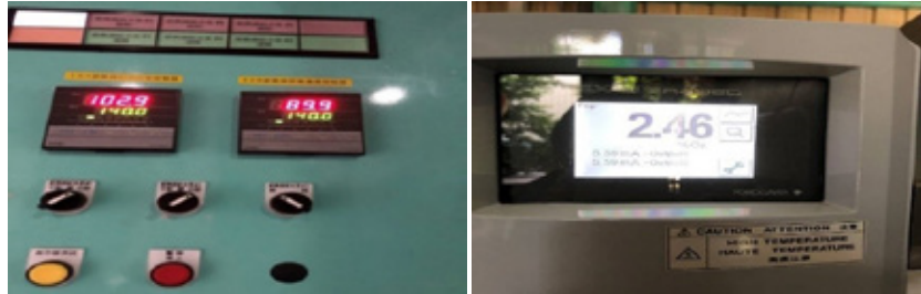
▲ 鍋爐燃燒數據轉傳 EMS 記錄以取代人力抄表
