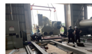
塗裝工場第二噴塗線 900RT 水冷式定頻離心式冰水主機更新
